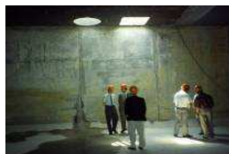
Bassin enterré visitable
